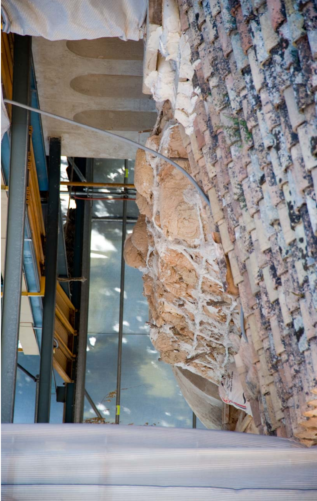
LÁMINA 92: RESTAURACIÓN DE LA BÓVEDA DE MOCÁRABES DE LA SALA DE LOS REYES DESDE LA PARTE ALTA DE LA SALA DE LAS DOS H. FOTOS: FIESTAS MORENO, M.
