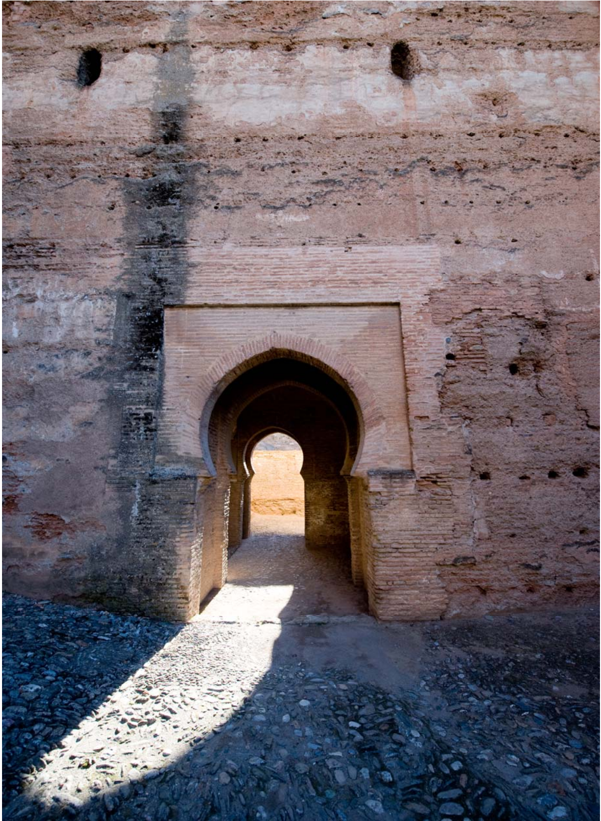
LÁMINA 1 FACHADA INTERIOR DE LA PUERTA DE LAS ARMAS. FOTOS: FIESTAS MORENO, M.
