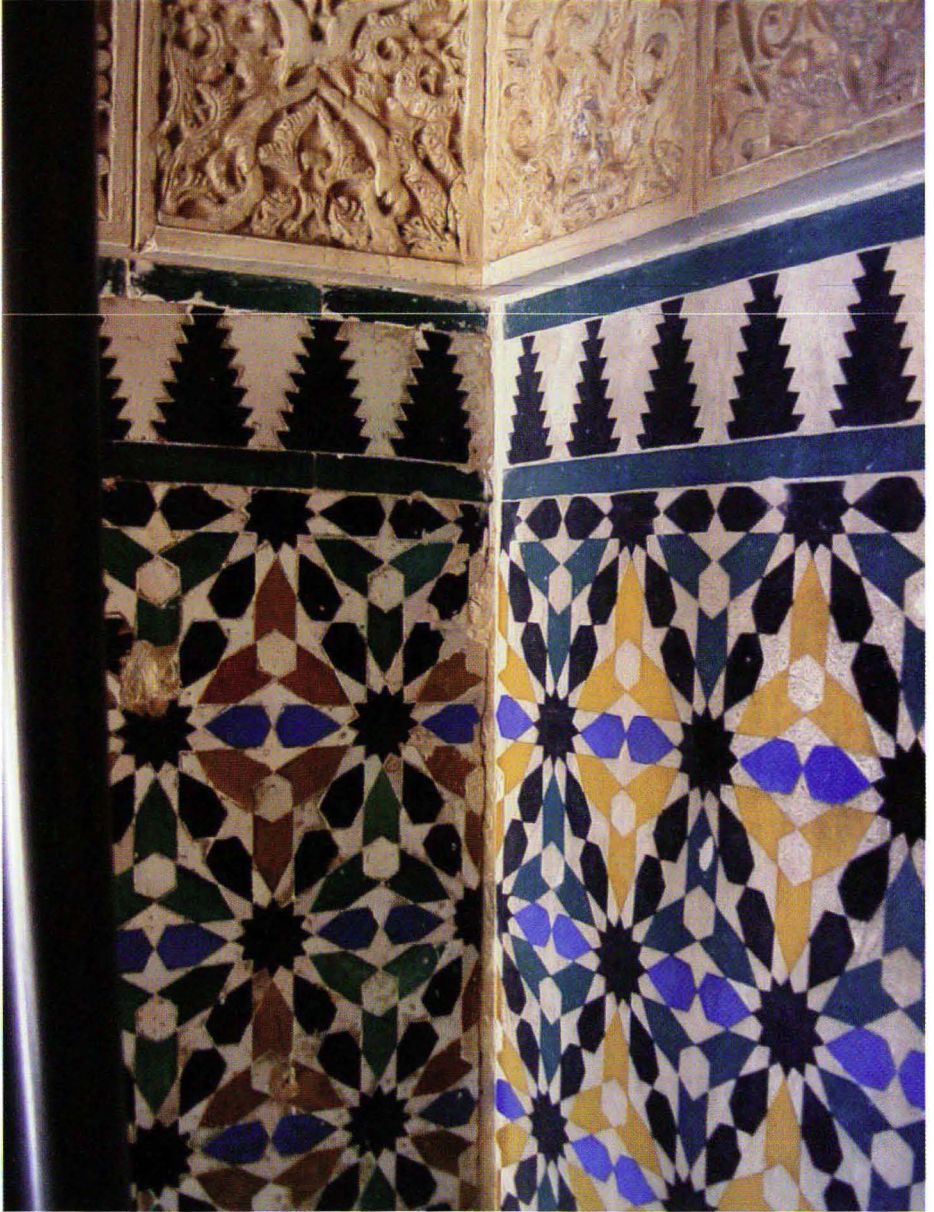
Fot. 5. Sala de los Reyes, detalle del zócalo de la esquina nordeste. La mitad de la izquierda es el único zócalo alicatado original de toda la sala.
