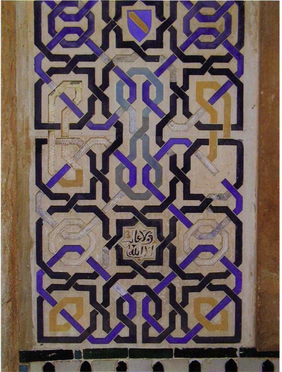
Fot. 11. Fachada del Palacio de Comares, detalle de la zona reintegrada del alfiz alicatado del lado oriental de la puerta oeste. Se aprecia la junta horizontal entre las dos placas así como los vaciados realizados en éstas para introducir el estuco coloreado.
