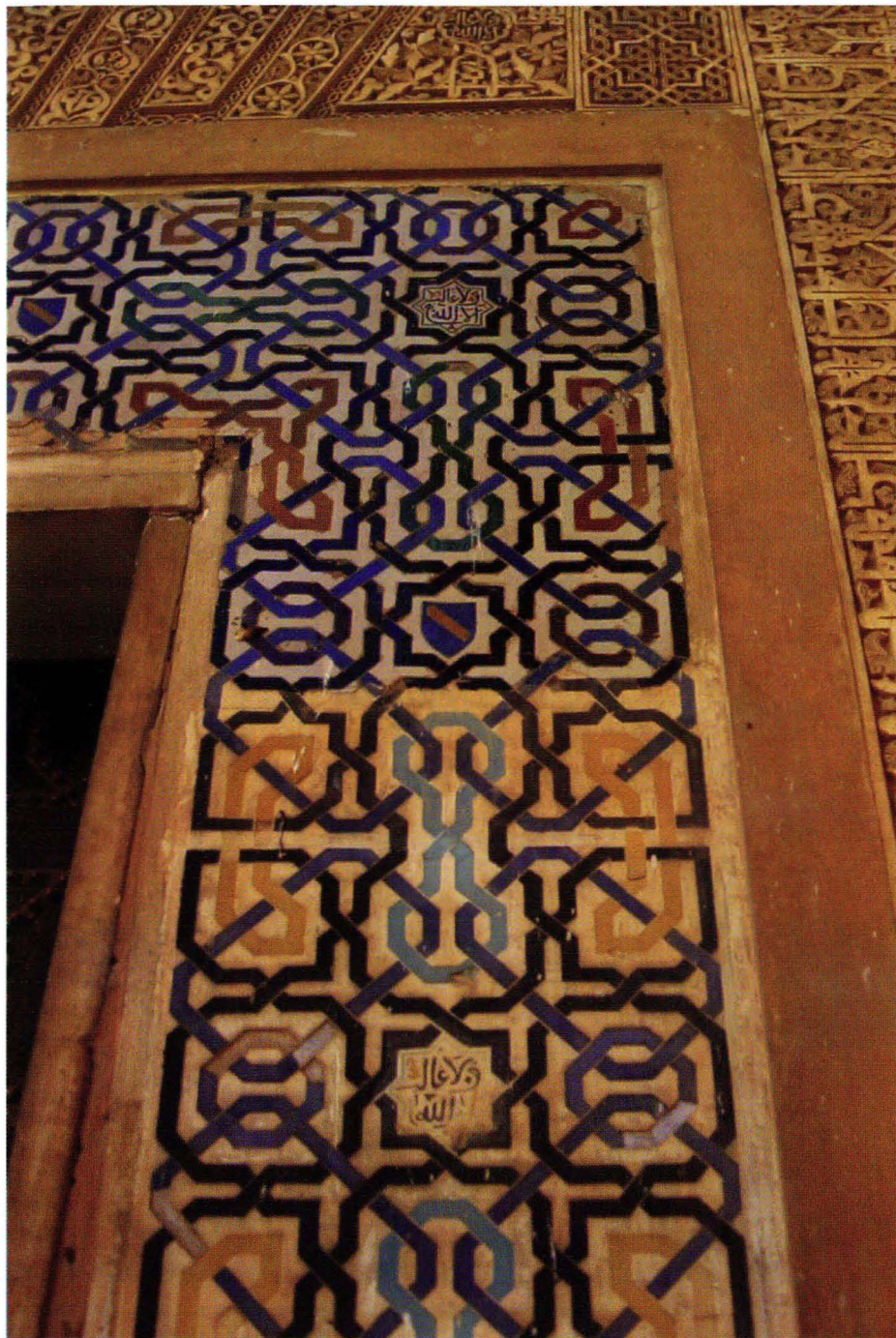
Fot. 10. Fachada del Palacio de Comares, puerta oeste. De cerca se aprecia con claridad la diferencia entre los alicatados originales de la parte alta y la reintegración con estuco en la zona baja.
