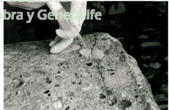
Lám. 5. Inyección de resina en uno de los desplazados de la columna nº 2.
