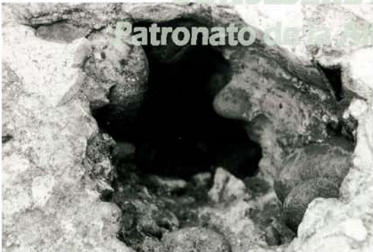
Lám. 4. Profundidad de una de las coqueas de la columna nº 1.
