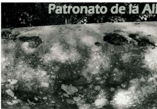
Lám. 18. Estado de conservación columna nº 1.
