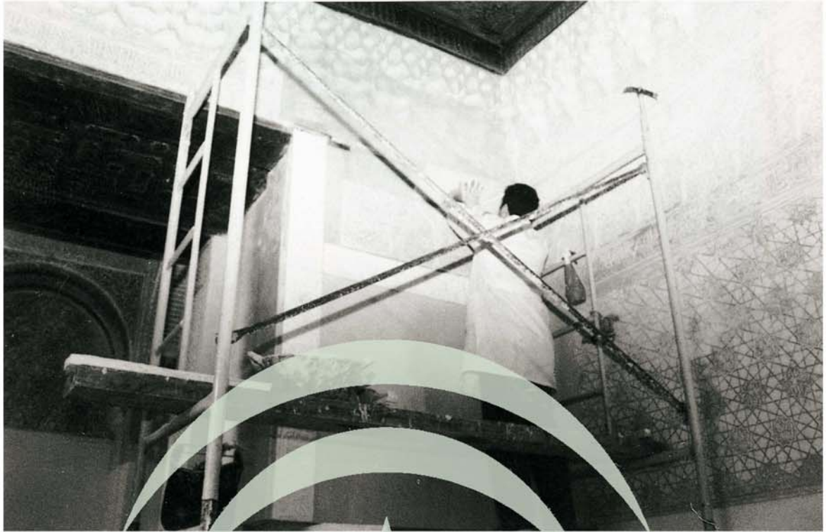
Lám. 28. Proceso de restauración de escayolas en el corredor de salida desde el Patio del Cuarto Dorado al Patio de los Arrayanes.
