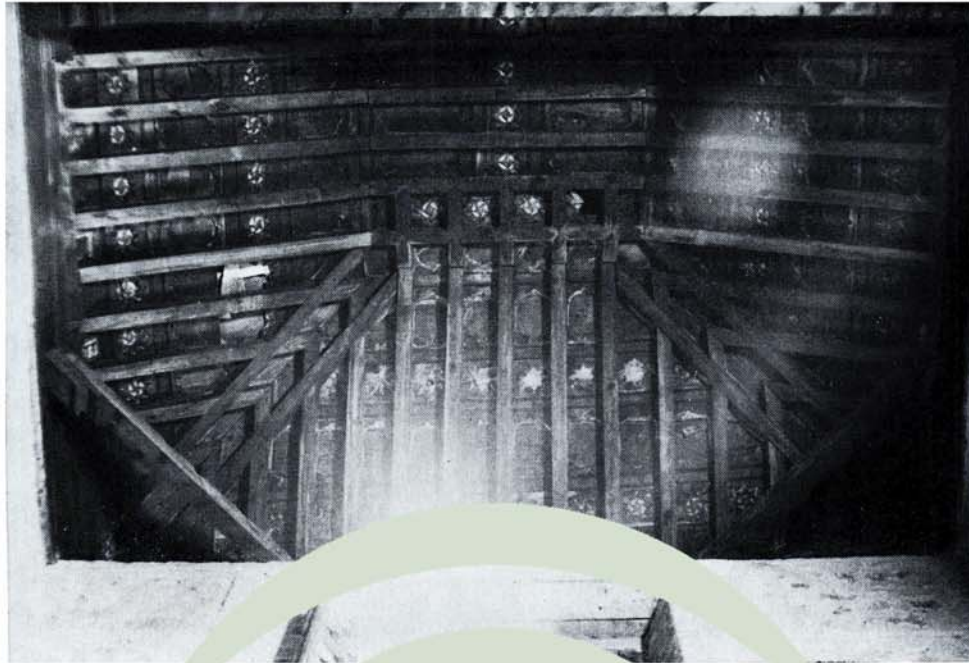
a) Armadura de limas moamares con decoración de menado y cuadrales, en la nave central de la iglesia de San Andrés (s. XVI).
