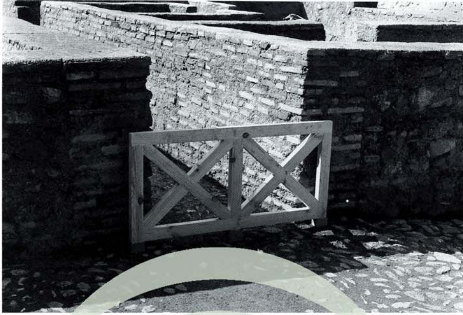
Lám. 34. Detalle del Barrio Castrense en la Alcazaba, una vez consolidados los muros y el pavimento, con la valla de protección en el acceso a una de las calles secundarias.
