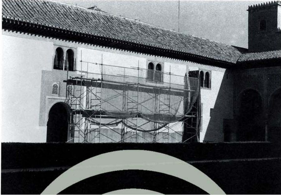
Lám. 42. Enfoscado de los muros laterales del Patio de los Arrayanes, atacados por la humedad de las jardineras.
