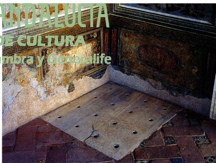
Losa perforada en la torre de la Estufa. APAG, 2007 (fotografía: Adrian Tyler)
